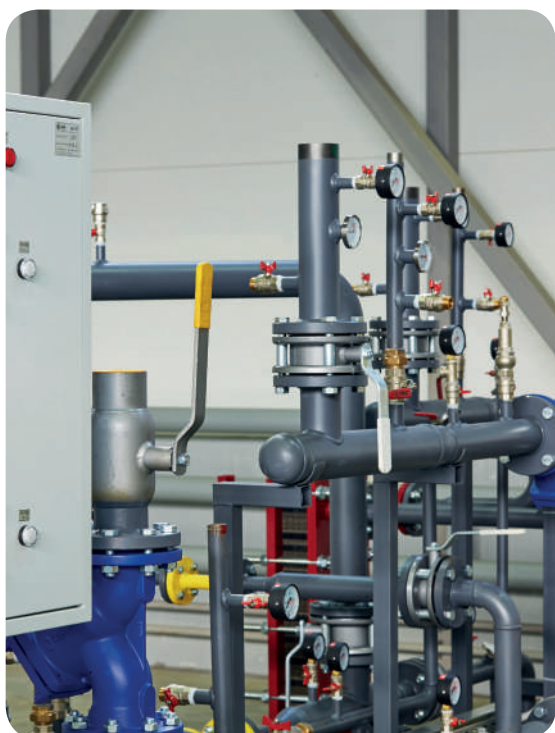
ИНДИВИДУАЛЬНЫЙ ТЕПЛОВОЙ ПУНКТ
