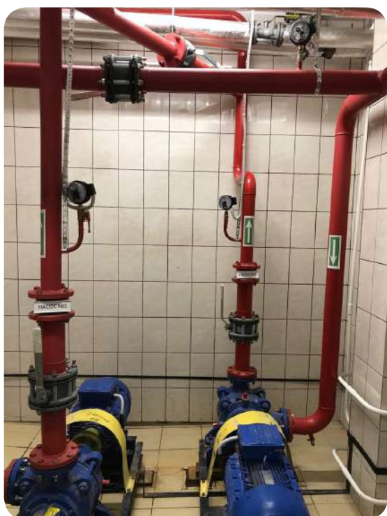
ИНДИВИДУАЛЬНЫЙ ТЕПЛОВОЙ ПУНКТ
